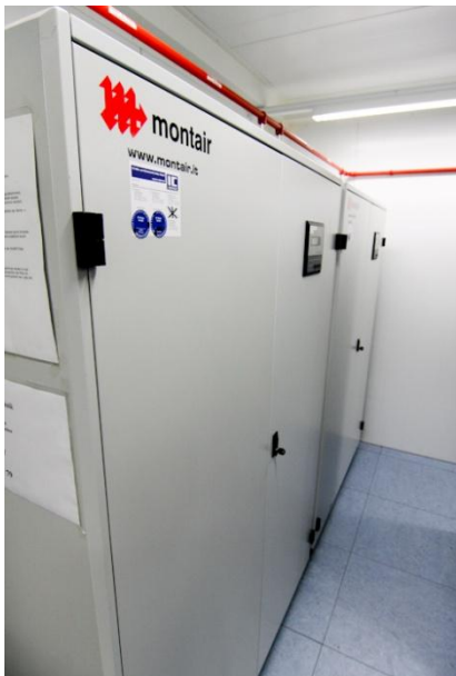
Die notwendige RZ Kühlung mit Brandfrüherkennung
